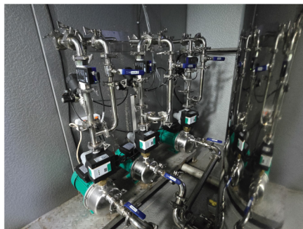
신규 펌프 및 유량계
