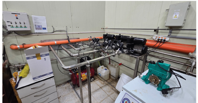
구형 이송라인 및 펌프 밸브류
