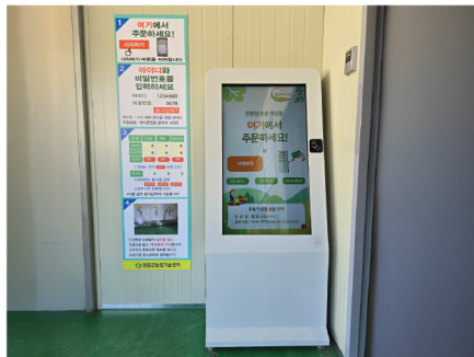
자동분주 키오스크 설치
